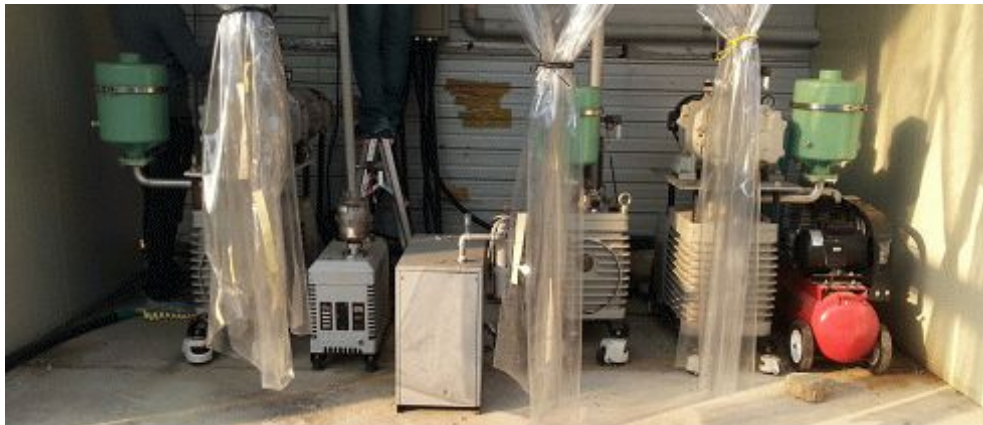
<그림 3.2.141 차양내에 설치된 펌프>
