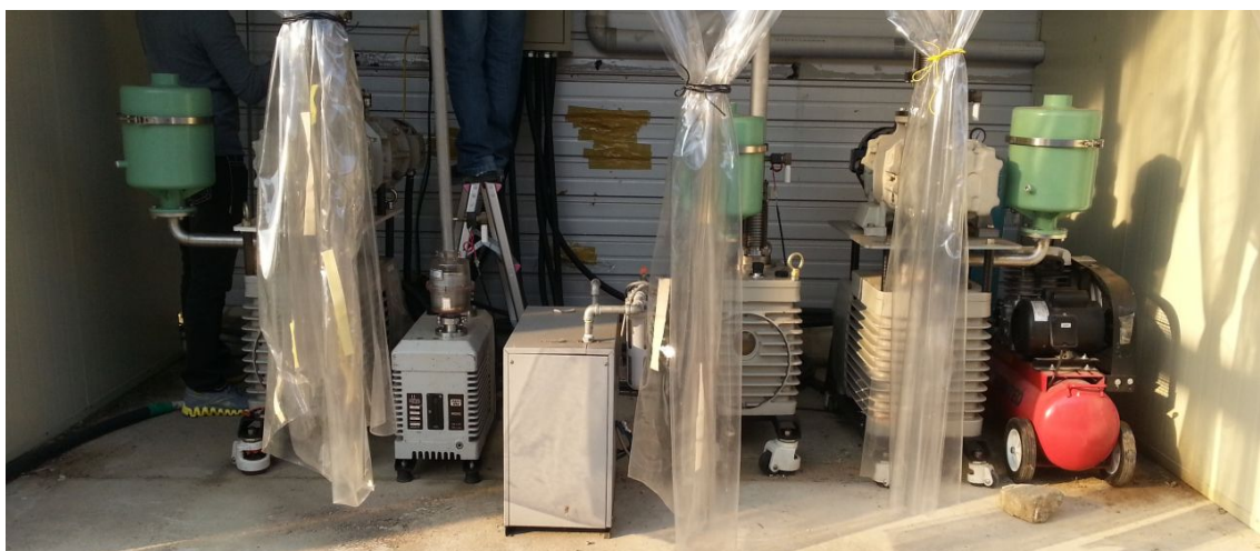
<그림 3.2.172 로타리 펌프 및 부스터 펌프>
