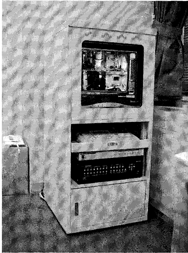
<통합적 안전점검을 위한 CCTV 설치; Main Controller (2003. 10)>
