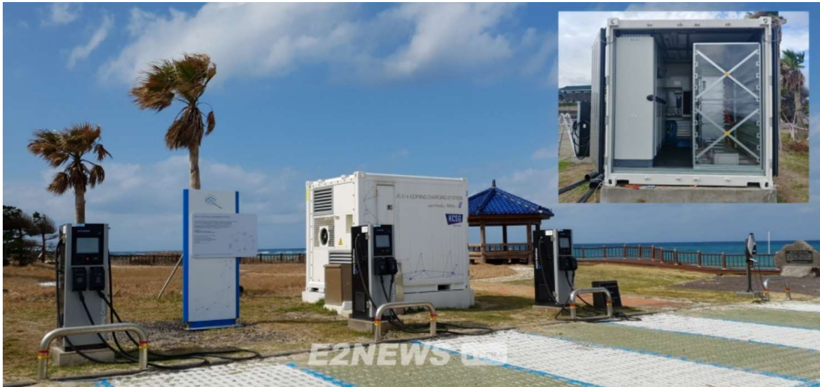
[그림 1-44] BMW사 전기차 폐배터리를 활용해 제주에 시범 설치한 ESS 충전소
