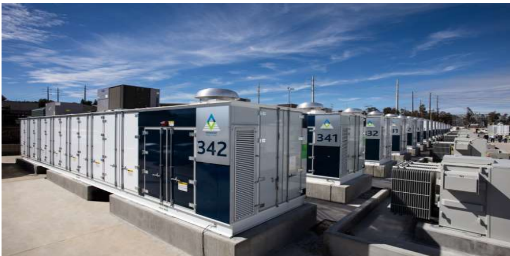
[그림 2-27] 캘리포니아에 설치된 240MWh의 대용량 ESS
