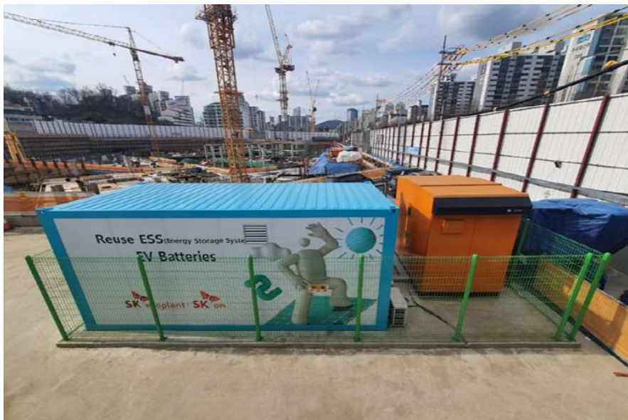
[그림 1-48] 아파트 건설현장에 설치된 ESS 연계 전력공급시설
