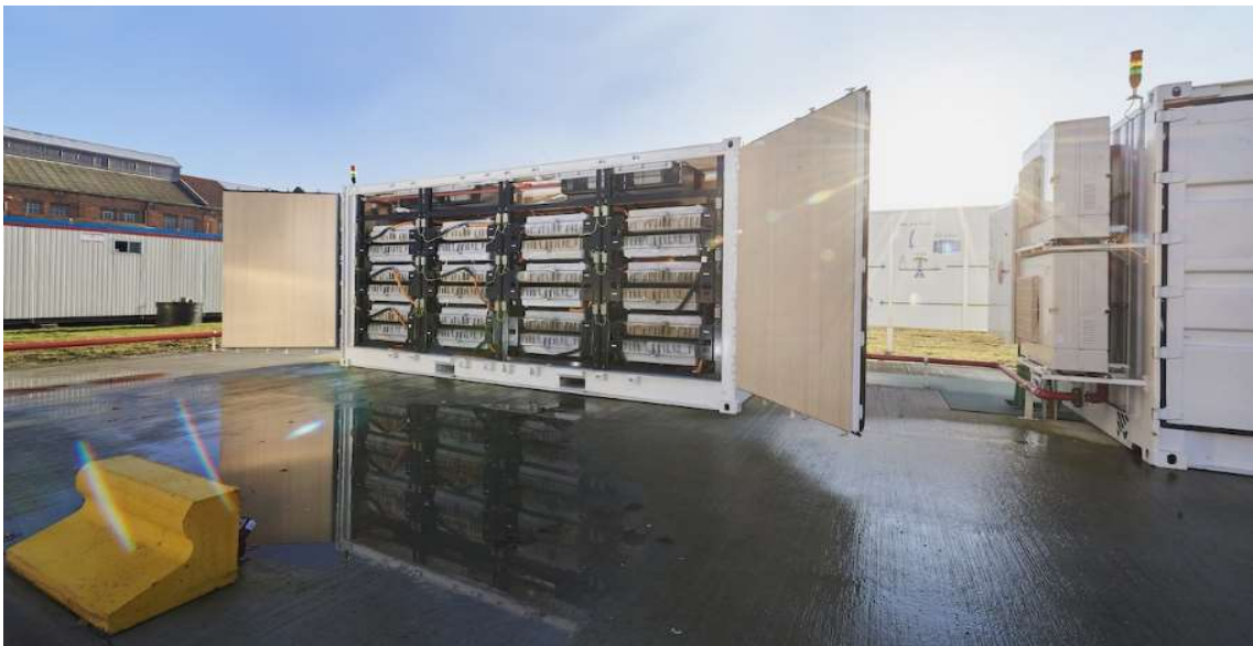
[그림 1-30] 벨기에에 설치한 1.2MW/720kWh급 ESS 설치 프로젝트
